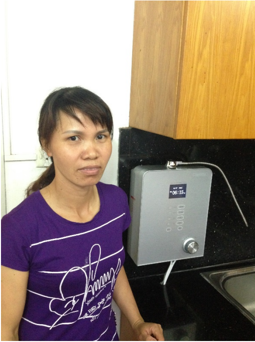
Công ty môi trường Việt Nam – Láng Hạ – Hà Nội (Máy lắp đặt ngày 18/7/2017)
